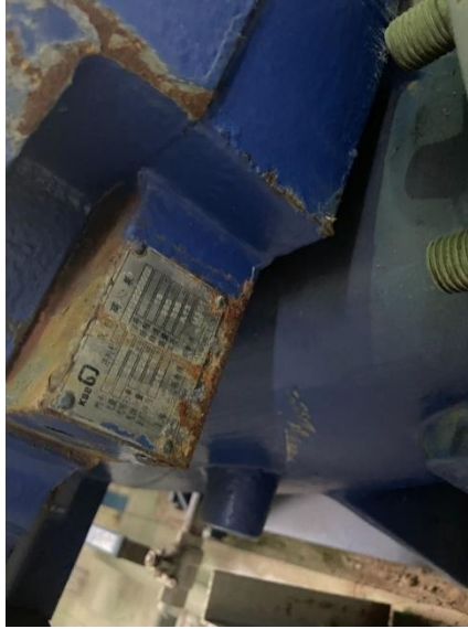
图 3.2-7 现状合作增压泵站照片
