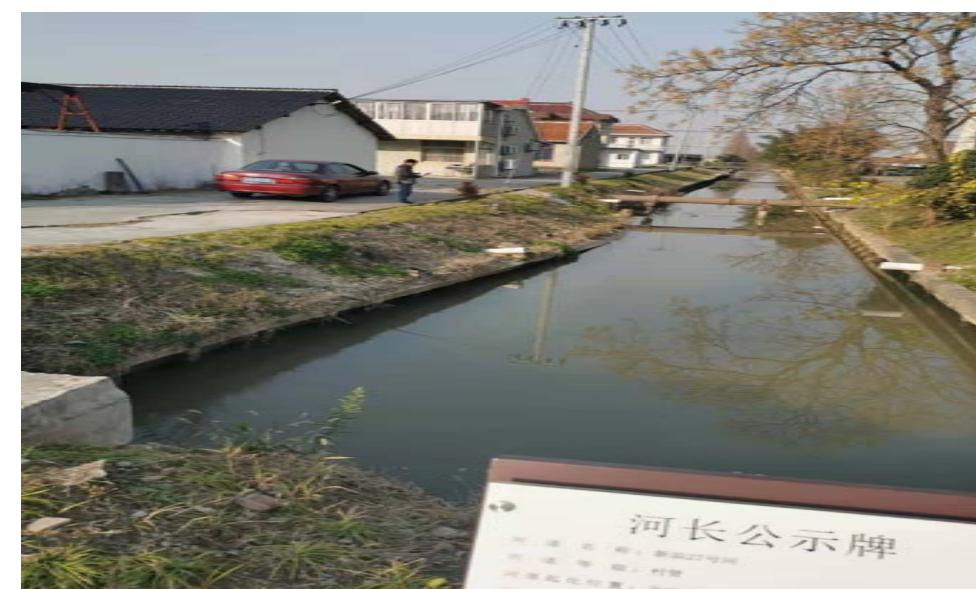
新浜北机口引水河已建护岸损坏现状图
