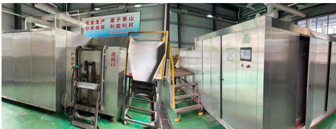
图 9-11 三星镇有机物循环利用中心现场图
