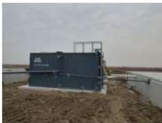
一体化冲洗废水处理站
