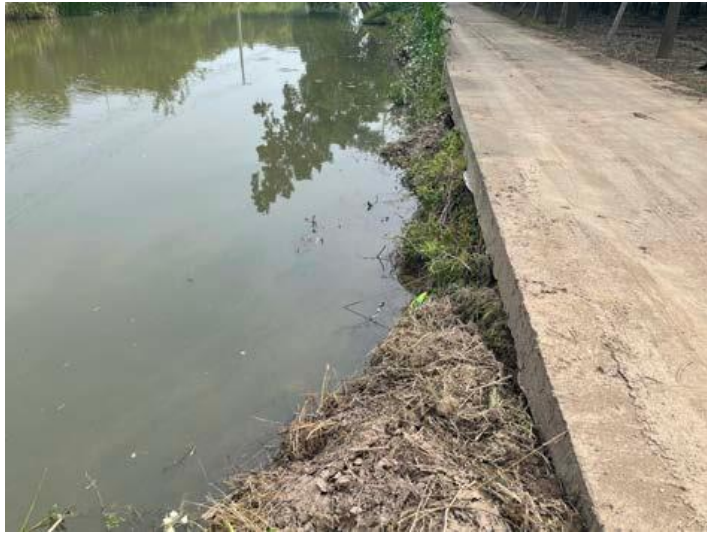
附图 10-16 河坡坍塌严重河段
