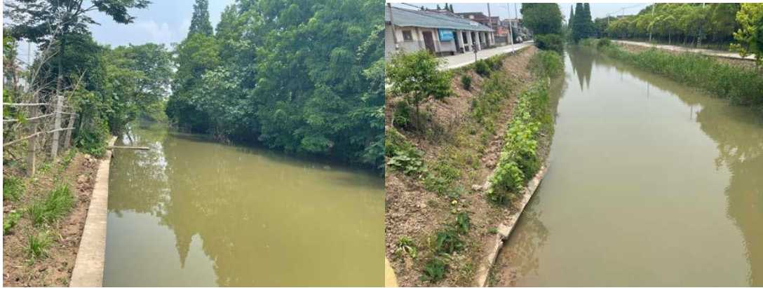
附图 10-4 出现损坏桩板式护岸
